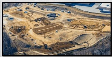
Ketidakpatuhan Pelan Kawalan Hakisan dan Kelodak (ESCP)
