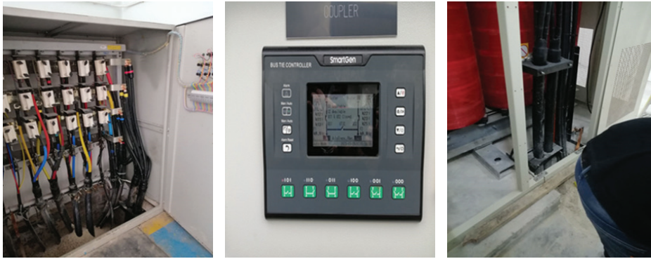
Foto 8.5 : Kerja-kerja membekal, memasang, mengujilari dan mentauliah pemasangan infra kabel elektrik bagi masukan bekalan utama serta kerja-kerja yang berkaitan untuk bangunan Pusat Data baharu
